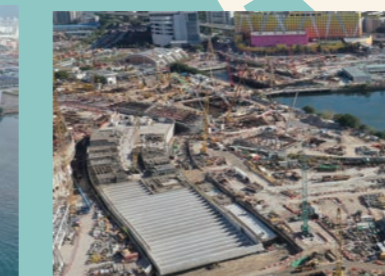
在啟德的明挖回填隧道、低於地面道路及地下行車道的回填工程 Backfilling works for cut-and-cover tunnel, depressed road and underpass at Kai Tak
