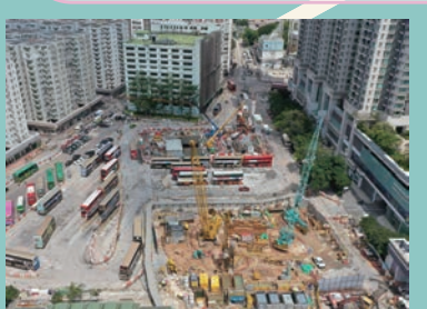
在馬頭角的明挖回填隧道工程 Construction of cut-and-cover tunnel at Ma Tau Kok
